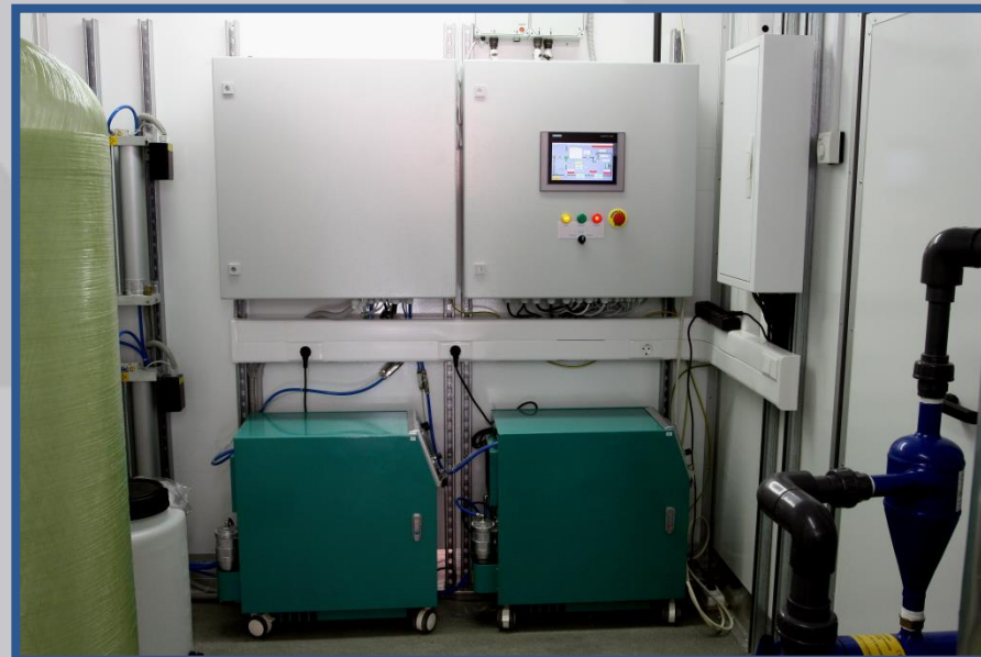
Автоматизированная система управления
